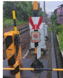
踏切支障報知装置
