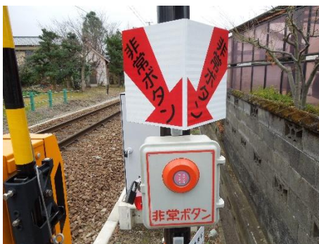
踏切支障報知装置
