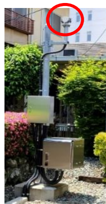
地上無線機アンテナ（赤丸部）
